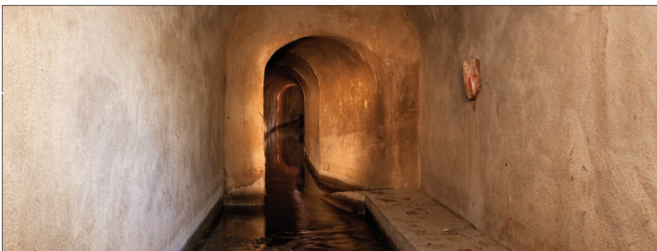
Red de drenaje urbano en la Casa de Campo
