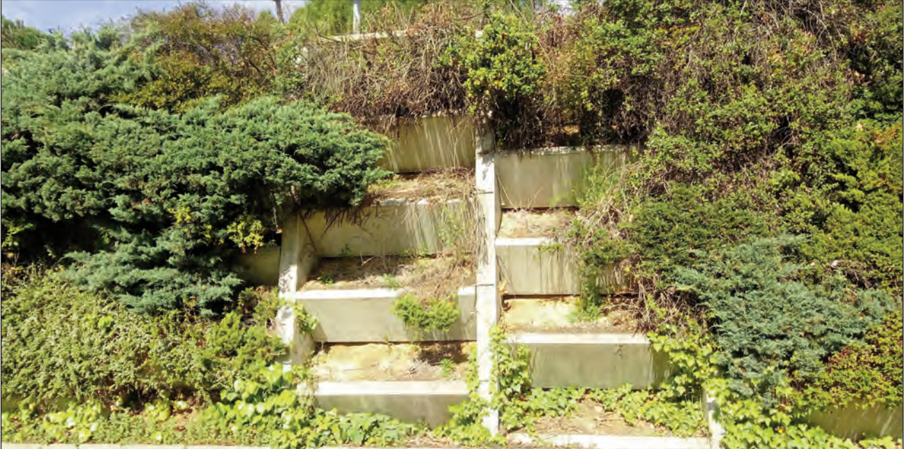
Muro jardinera en el Parking de la Universidad Europea de Madrid, Campus de Villaviciosa de Odón (Madrid)
